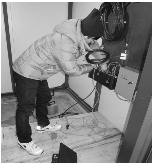
Рис. 4. Проверка оборудования на сеймостанции «Посъет»
