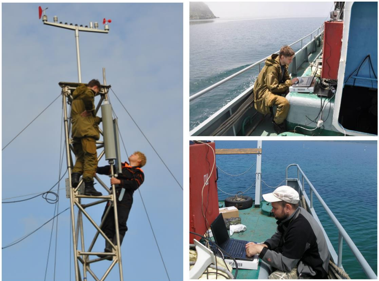
Рисунок 3.17 - Монтаж Wi-fi антенны на МЭС м. Шульца и проверка дальности акваторной Wi-Fi связи на морских судах
